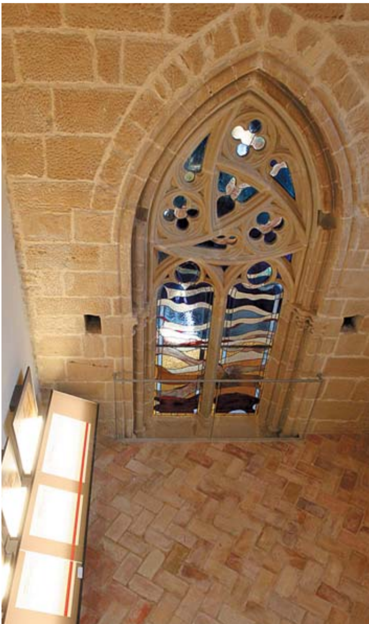
UNA ALACENA TAPABA EL ARCO. Unas estanterías a modo de alacena en la casa del campanero ocultaban el arco de piedra de la imagen, que ha sido restaurado y redecorado con una vidriera de nueva factura. CALLEJA
